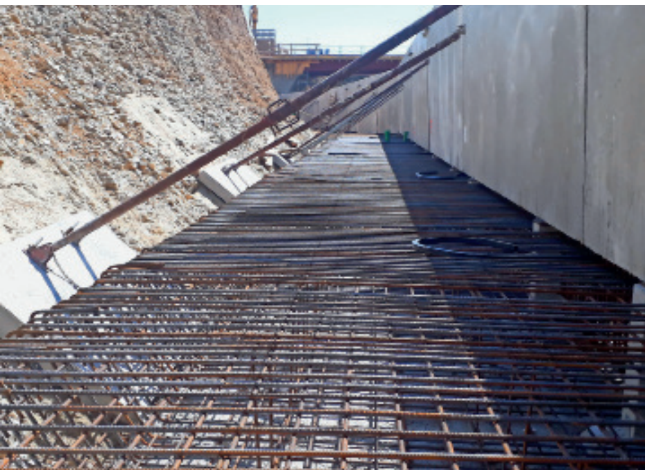
Abbildung 5: Die Anschlussbewehrung der Wandelemente ist im Fundamentkasten nach statischen und konstruktiven Erfordernissen durch Betonstahlbügel ergänzt worden.
