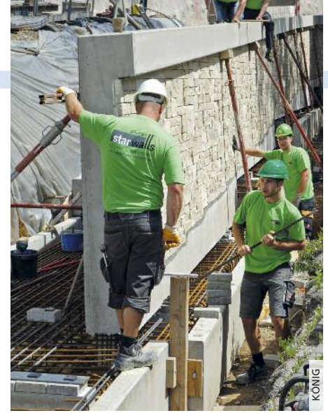
Horb-Mühringen: Vorgefertigte Mauerelemente, bereits ab Werk mit Jura-Kalkstein verblendet, werden talseits auf der Fundamentkonstruktion fixiert.
