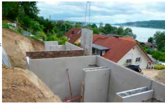
Drei-Scheiben-Rückverankerung im Hang aus Hohlkammerwänden als zusätzliche statische Maßnahme in besonderen Fällen.
